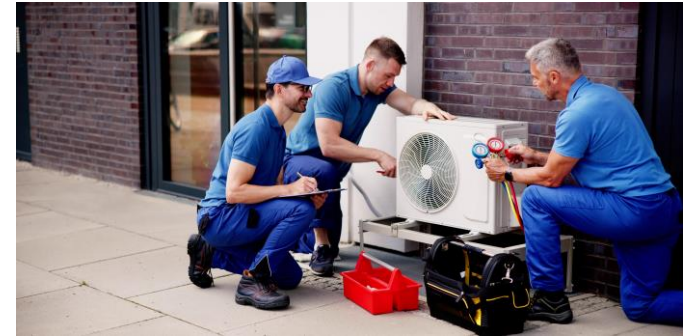
Daikin Service- und Installationspartner
