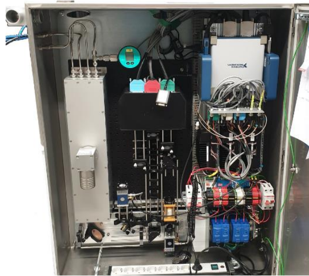
QCL-Sensorplattform; installiert in einem Industrierack. (© CHASE/Moser)
