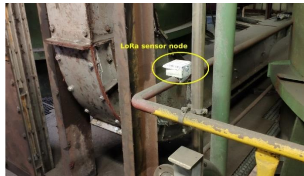
LoRa Knoten in Industrieumgebung (© Lakeside Labs GmbH)
