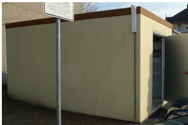
Abbildung 13: Ortszentrale in einem Container
