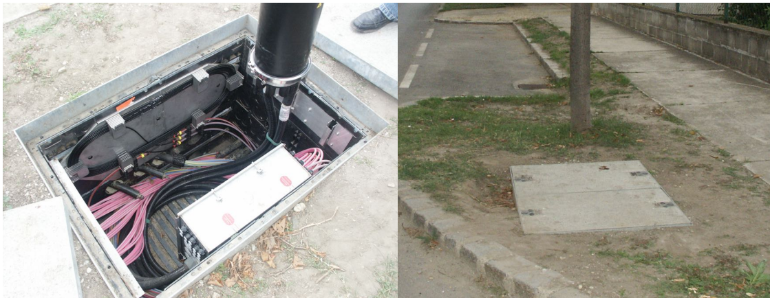
Abbildung 44: Straßenschacht bestückt für 72 Mikrorohre mit Betondeckel
