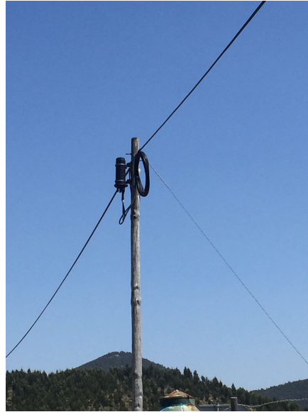
Abbildung 45: LWL-Luftkabel auf Holzmasten
