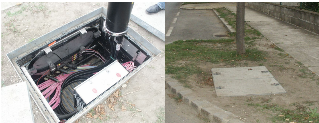
Abbildung 47: Straßenschacht bestückt für 72 Mikrorohre mit Betondeckel
