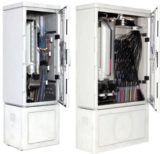
Abbildung 48: Straßenschränke für 48 und 96 Mikrorohre
