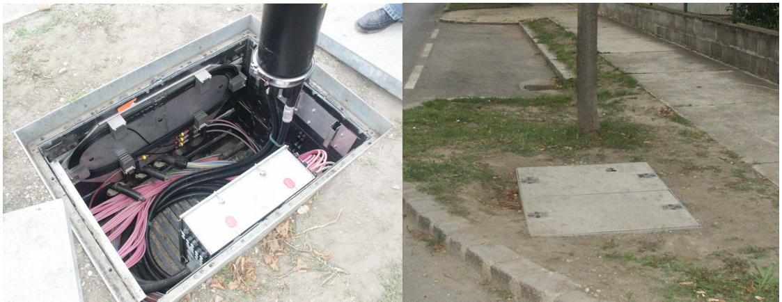
Abbildung 44: Straßenschacht bestückt für 72 Mikrorohre mit Betondeckel
