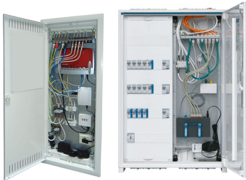
Abbildung 22: Wohnungsverteiler mit und ohne kombiniertem Elektroverteiler
