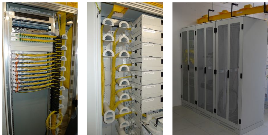
Abbildung 46: Aktive Komponenten, Fasermanagement und 19"-Schränke in einer Ortszentrale
