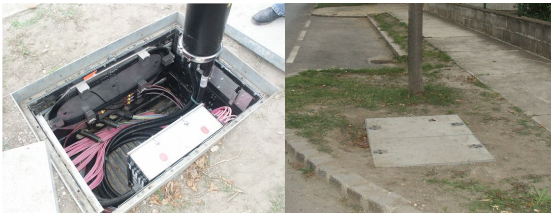
Abbildung 47: Straßenschacht bestückt für 72 Mikrorohre mit Betondeckel
