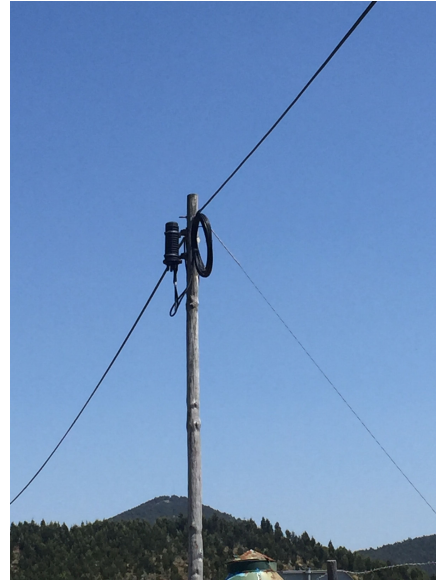
Abbildung 45: LWL-Luftkabel auf Holzmasten
